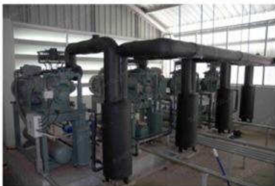
ห้องเครื่อง compressor unit พร้อม accumulator ขนาด 50 แรงม้า ยี่ห้อ
