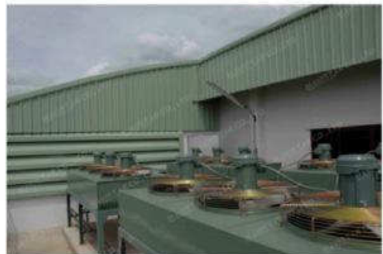
remote condenser นอกห้องเครื่อง
